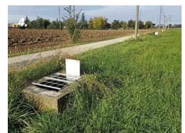
Fig.4: Chiusura automatica di un fossato, pianura padana orientale, IT www.crpa.it/
